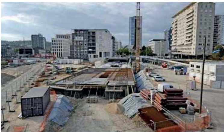
Un rythme de pose impressionnant, avec deux poutres et trois dalles alvéolées posées toutes les 30 minutes. Photo F. MERCENIER
